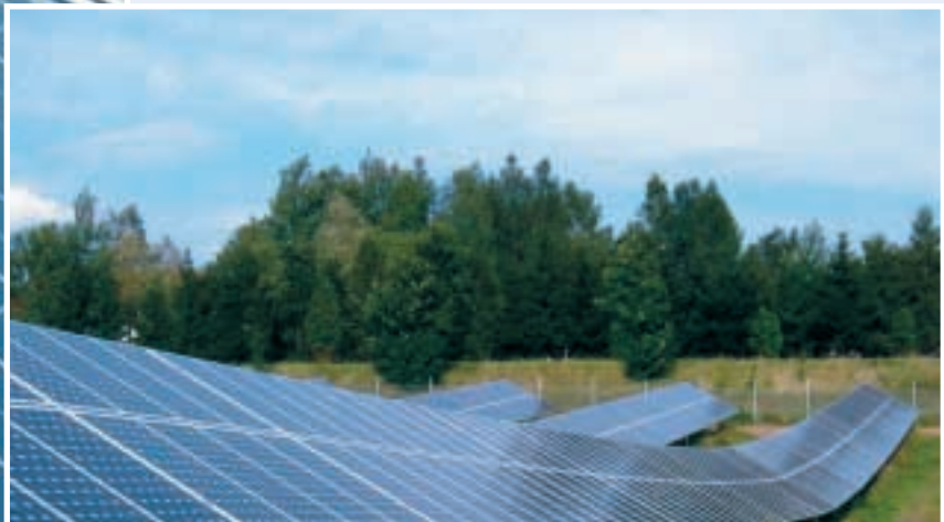
2005: Sonnenfonds Donau 4,1 MW, Teilpark Hofkirchen
